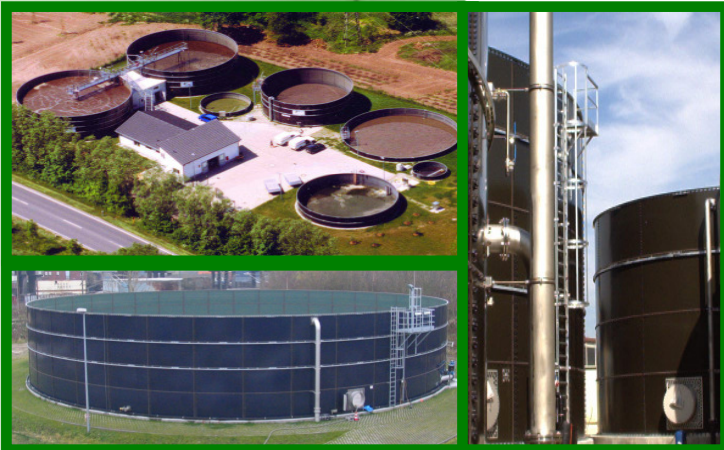
Impianti di depurazione di acque civili ed industriali
