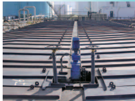
Impianto industriale con raschiatore a catena in plastica
